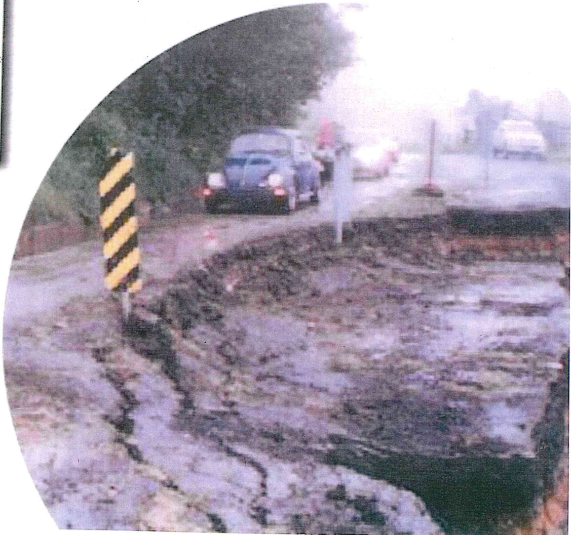
Figura 7. Huracán Dean. a) Trayectorias, b) Daños en carretera de Huixtla. Fuente: Centro Nacional de Prevención de Desastres
